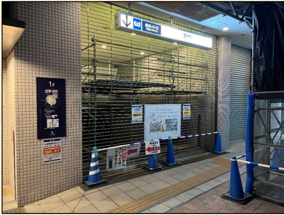
図 2-4 駅入口階段通路閉鎖状況
